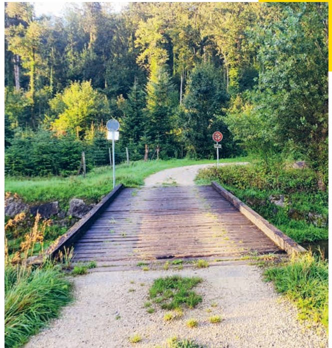
Die sanierungsbedürftige Surbbrücke.
