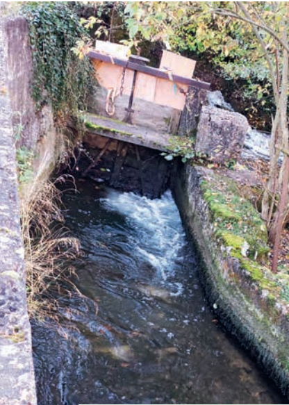
29 Der Endinger Mühlebach, kurz nach der Abzweigung von der Surb. Die Schleuse/Schieber ist nicht mehr in einwandfreiem Zustand.
